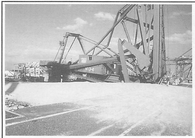
c) Collapsed Legs, Rokko Island
